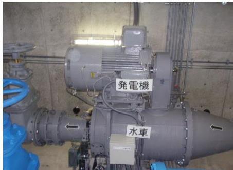
使用している発電機
