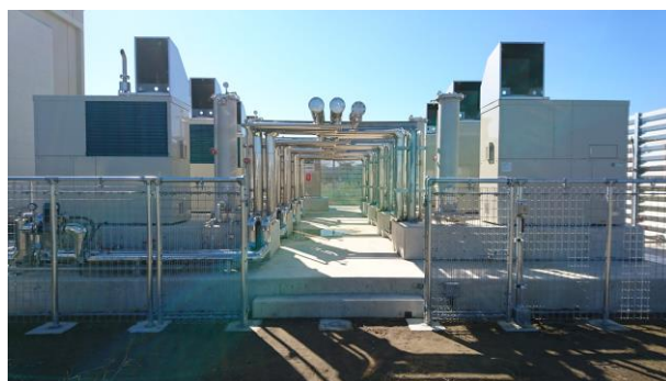
消化ガス発電施設
